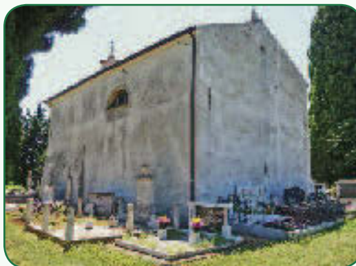
Crkvici je potrebna sanacija
